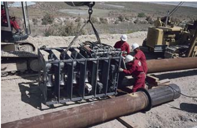
Instalación de sistema Tite Liner en mineraloducto de 24 pulgadas de diámetro – Antofagasta Chile
