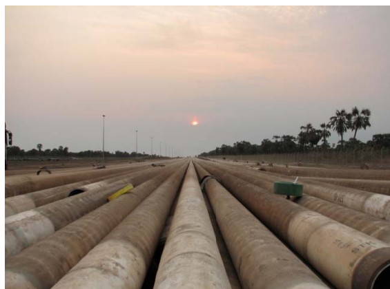
Preparación de lingadas para instalación de línea marina de 12" con Technip en Cabinda, Angola, África
