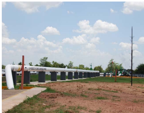
Instalación de sistema Tite Liner en Oleogasoducto para manejo de crudo amargo hidratado de 16" en Cunduacán, Tabasco - Pemex Exploración y Producción – Región Sur.
